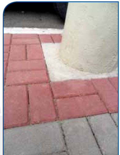
Acabamento em poste de energia
