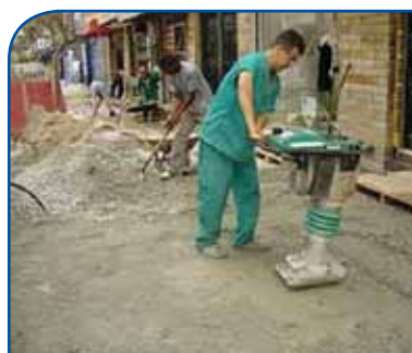
4º PASSO: Compactação da bica corrida / brita graduada e nivelamento com placa vibatória
