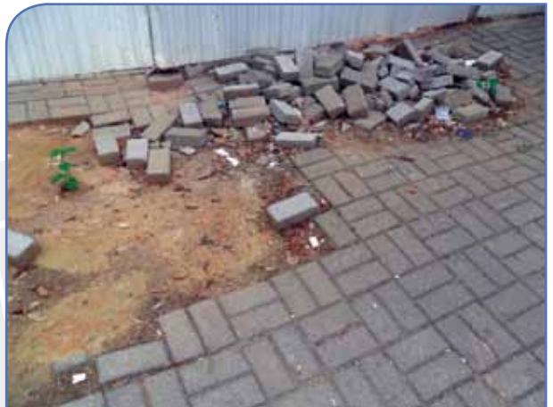
Resultado de compactação e travamento incorreto
