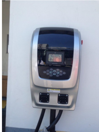
Figura 1 – Painel do sistema de carregamento instalado na garagem Rodoviária A. Matias
