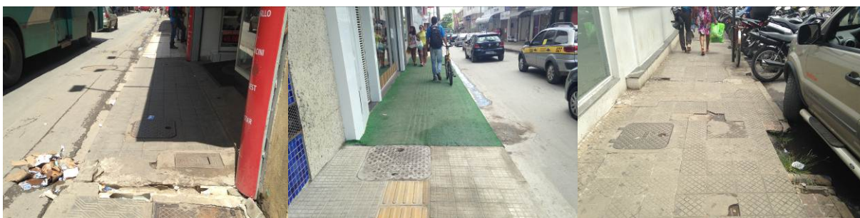
FIGURA 06: Calçadas inadequadas ao caminhar, em Montes Claros, na área de estudo. Registro Fotográfico: Arq. e Urb. Ana Luísa Pires, 2015.
