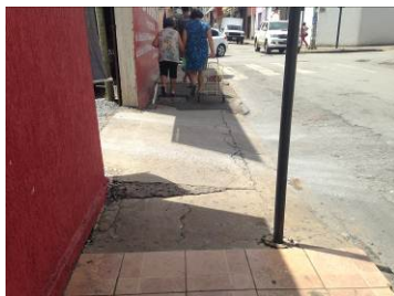
FOTO 09A: Calçada na rua D. Pedro II, inadequada ao caminhar. Registro Fotográfico: Arq. e Urb. Ana Luísa Pires, 2015.
