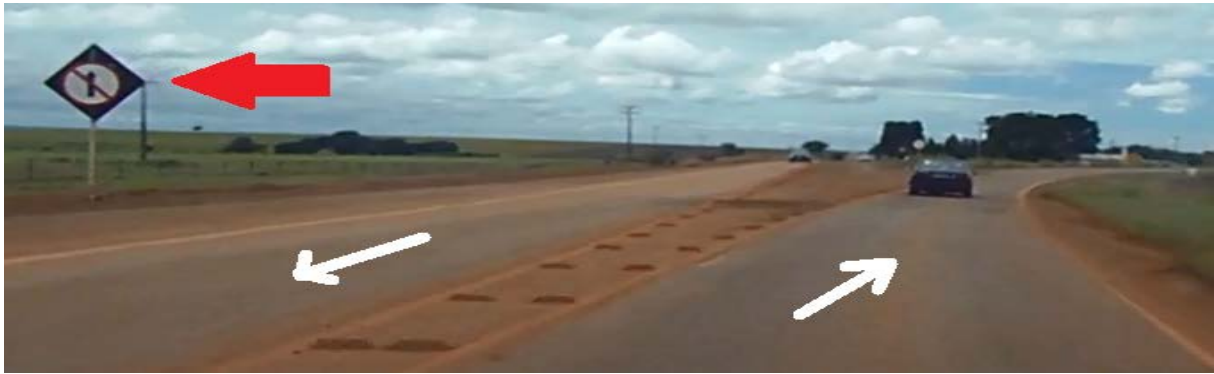
Figura 4 - Placa mal posicionada.
