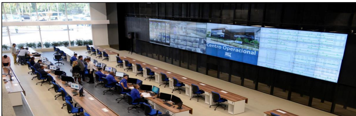
Figura 5 – Centro de Controle Operacional
